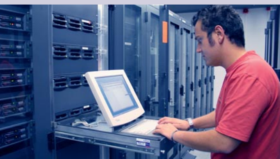
Im Allerheiligsten: das High-tech-Rechenzentrum der GISA GmbH
